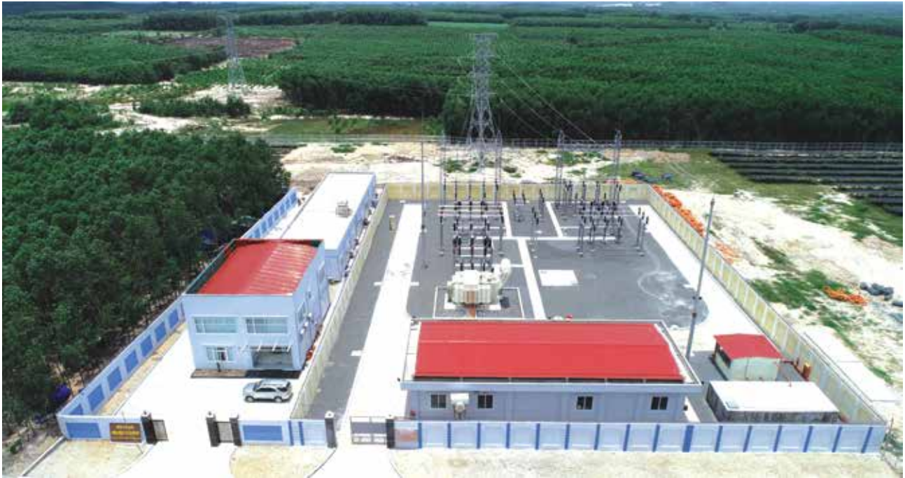
Trạm biến áp 110kV Nhà máy Điện mặt trời Sơn Mỹ 3.1
