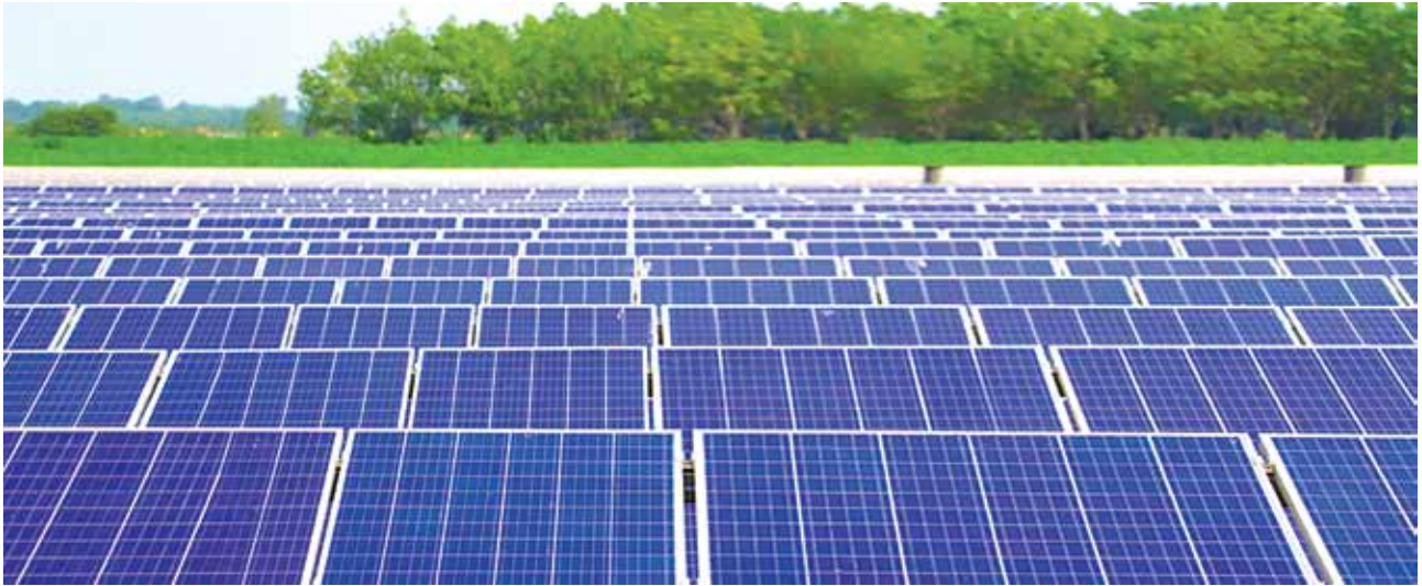
Nhà máy Điện mặt trời Dầu Tiếng 3
