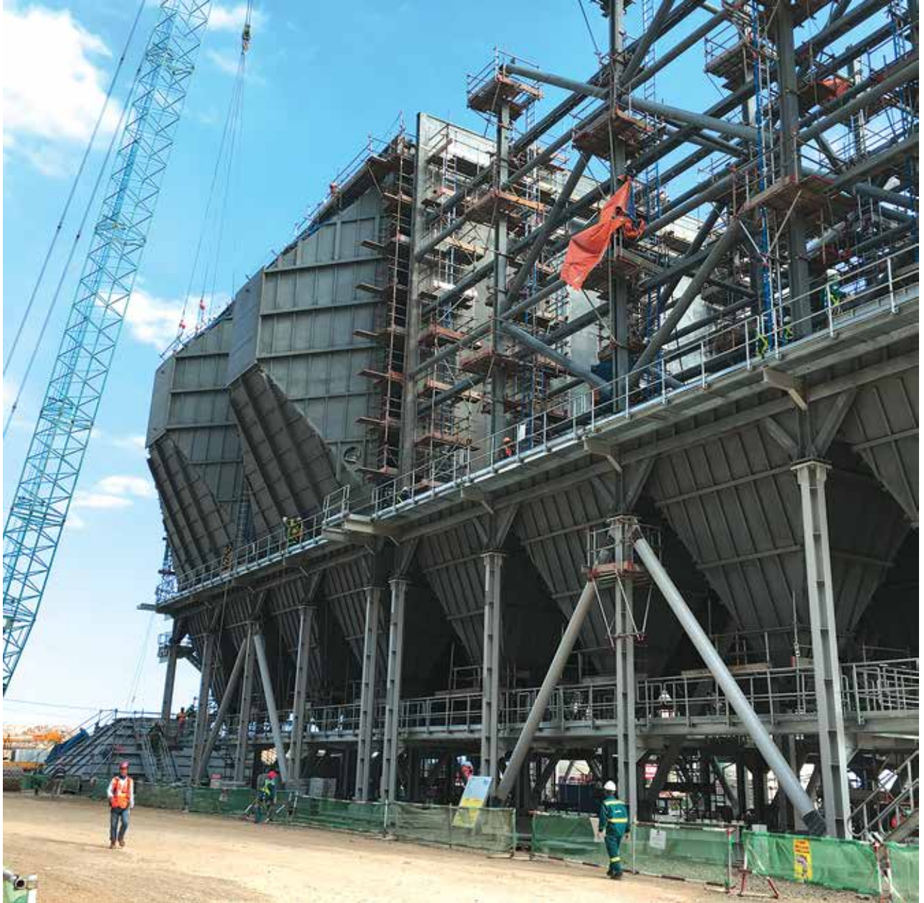
Hệ thống Lọc bụi tĩnh điện
